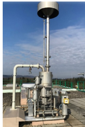
Vorlagenbehälter vor Umbau
