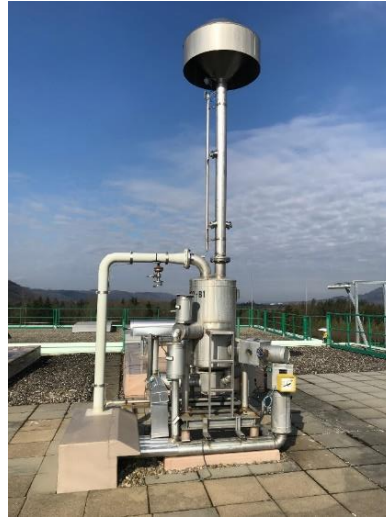
Vorlagenbehälter vor Umbau
